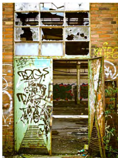
Hærverk på et bygg
