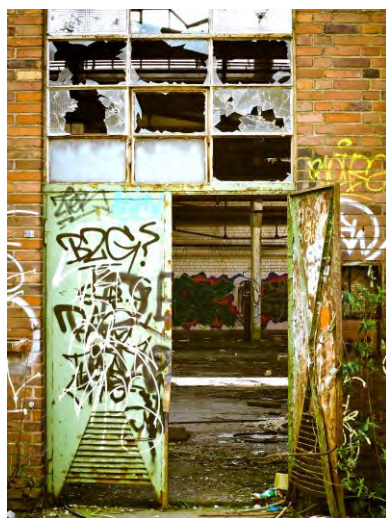
Hærverk på et bygg
